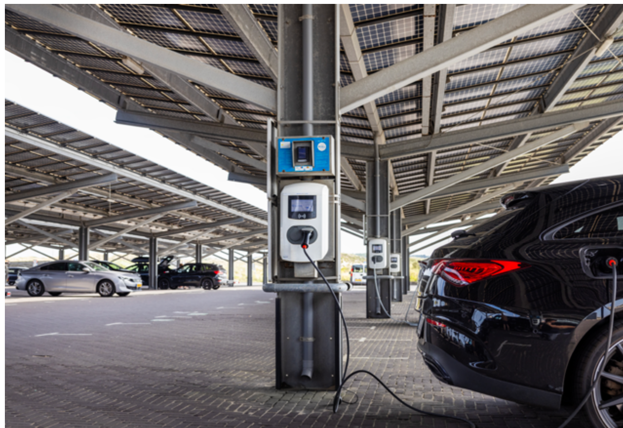
Voorbeeld van een laadstation met zonnepanelen in Bloemendaal aan Zee
